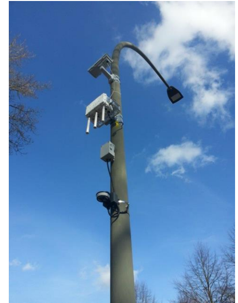
Straßenbeleuchtung mit allen Komponenten
