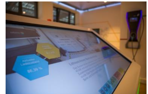
Visualisierung und Steuerung durch Energiezentrale (Juli 2016)
